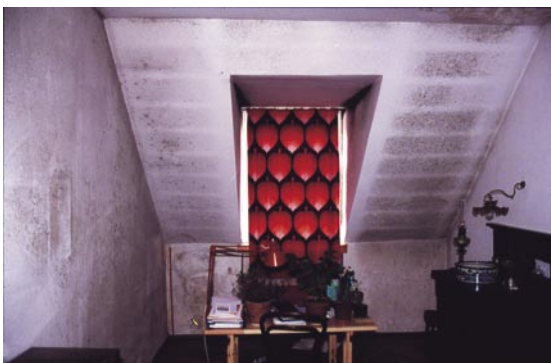
Abbildungen 1 + 2: Tauwasserschäden mit nachfolgender Schimmelbildung
