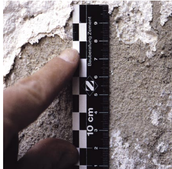
Abbildung 3: Schadensbild bei aufsteigender oder von außen eindringender Feuchtigkeit
